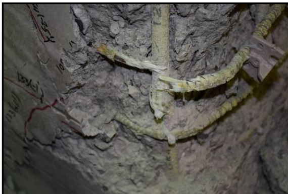
Fig. 8 – GFRP stirrup cut
