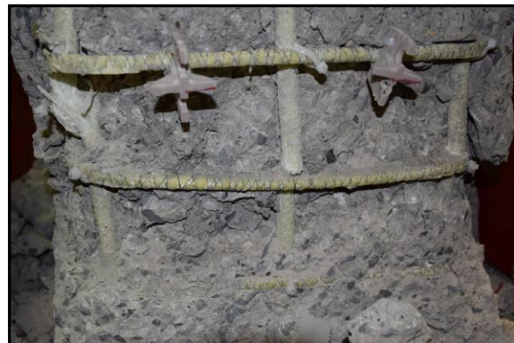
Fig. 9 – GFRP longitudinal bar fracture
