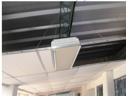
(d) Insufficient securing of suspended ceilings (H&S)
